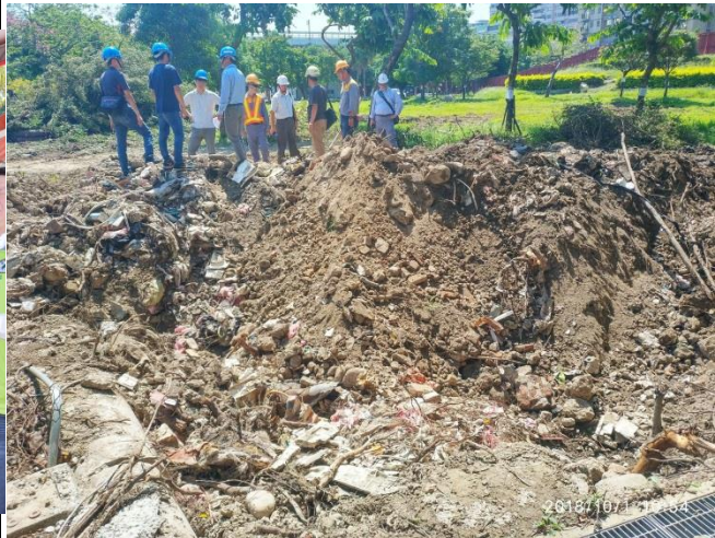
照片說明：工區土層夾帶營建廢棄物會勘
